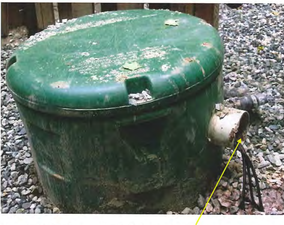
Photo 18 Station de pompage 1A située au sud du site 517 – traces de boues dans la conduite de trop plein
