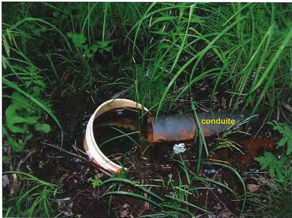
Photo 14 Installation septique 1 – conduite en provenance du centre des champs de l'élément épurateur
