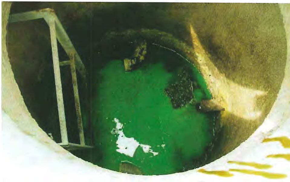
Photo 29 Installation septique 2 – station de pompage
