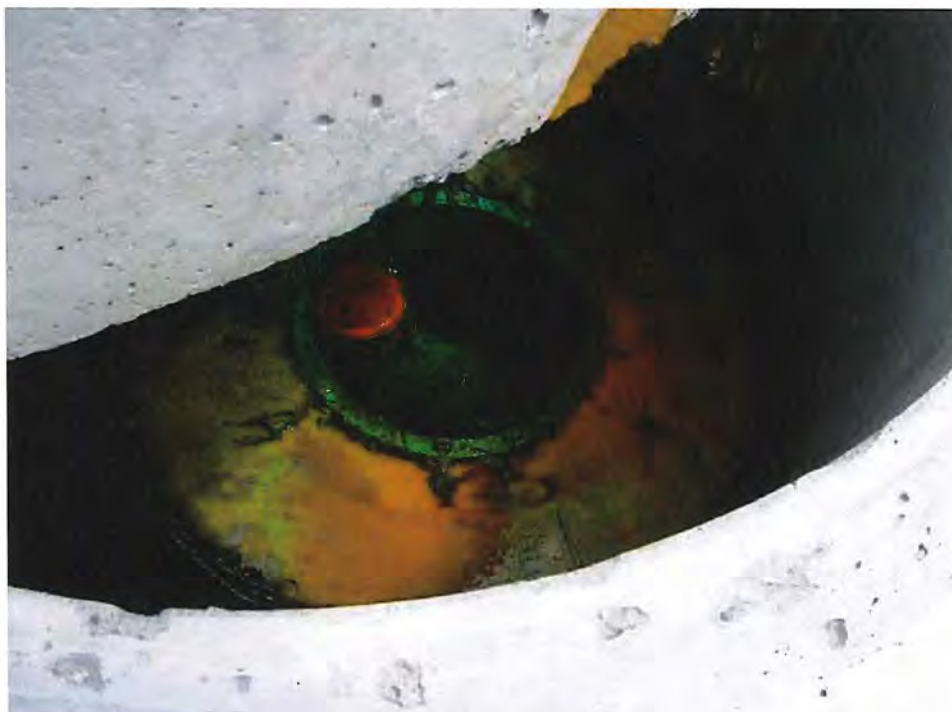
Photo 27 Installation septique 2 – premier compartiment de la fosse septique muni d'un système artisanal
