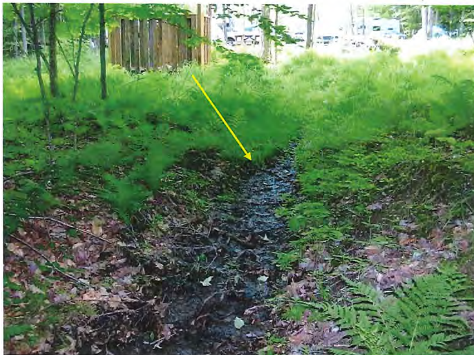
Photo 21 Station de pompage 1A située au sud du site 517 – traces d'écoulement dans le bois
