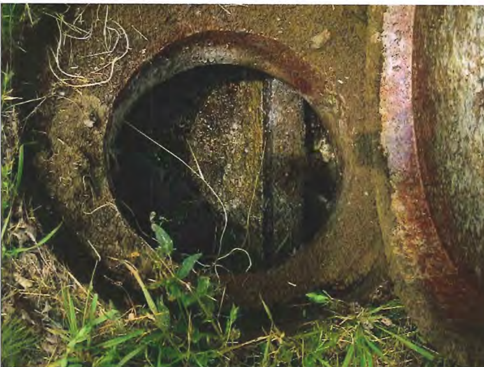
Photo 24 fosse septique du motel – premier compartiment très plein
