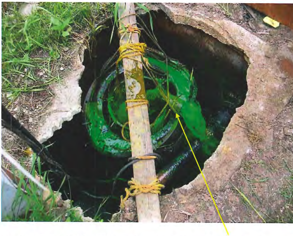
Photo 6 Installation septique 1 – station de pompage – installation artisanale et recirculation
