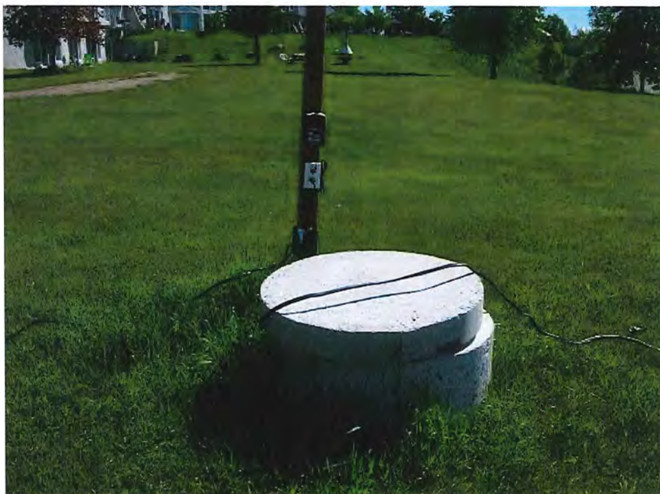
Photo 26 Installation septique 2 – premier compartiment de la fosse septique avec alarme
