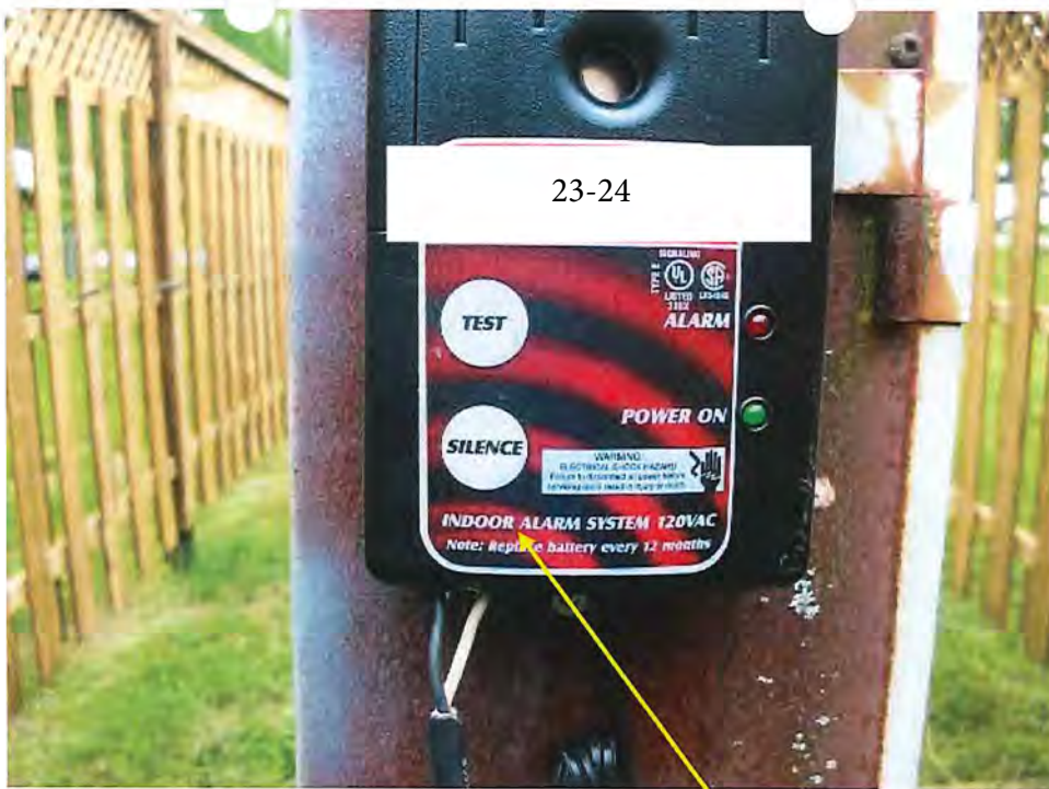
Photo 7 Installation septique 1 – station de pompage – nouvelle alarme d'intérieur
