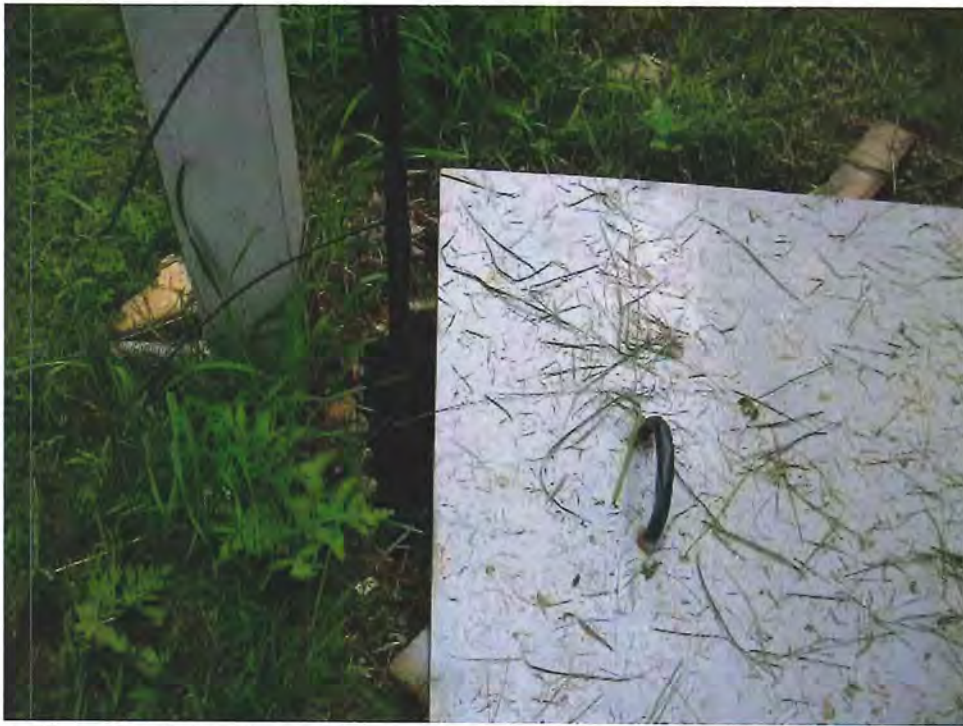
Photo 5 Installation septique 1 – station de pompage – couvercle non étanche
